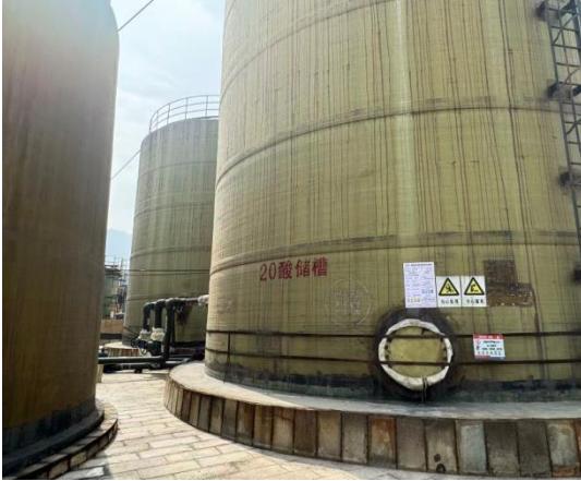
攀渝钛业废稀硫酸储罐
